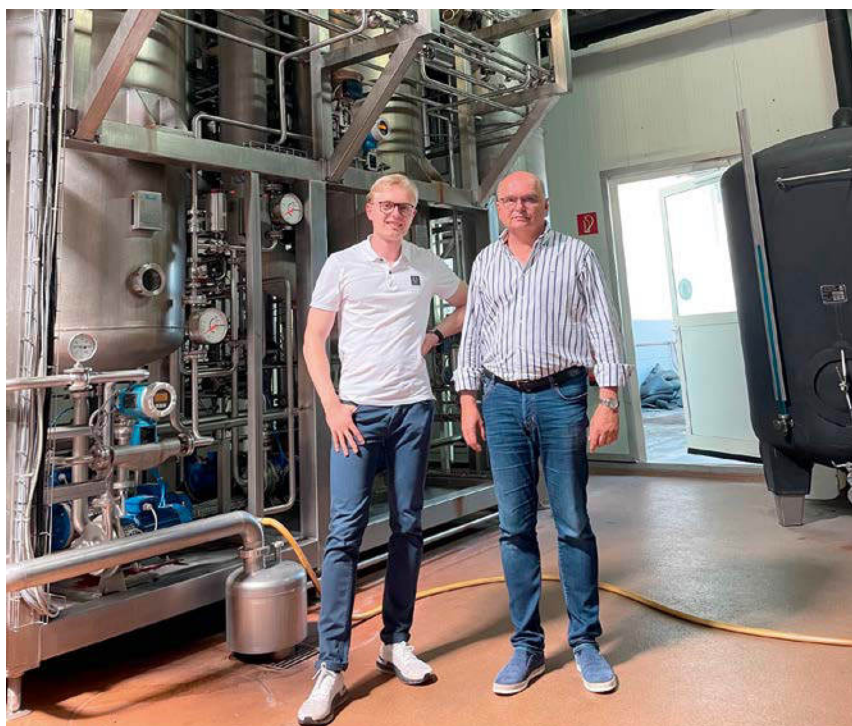
2014 installiert, ist die Anlage bei Adam Trautwein gut ausgelastet. Johannes (links) und Wolfgang Trautwein vor ihrer Anlage, die eine Leistung von 50.000 Litern pro Tag bringt.
